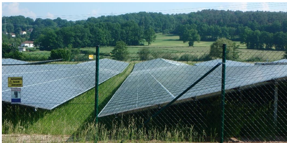
Abbildung 2: Beispiel einer Ost-West-Anlage
